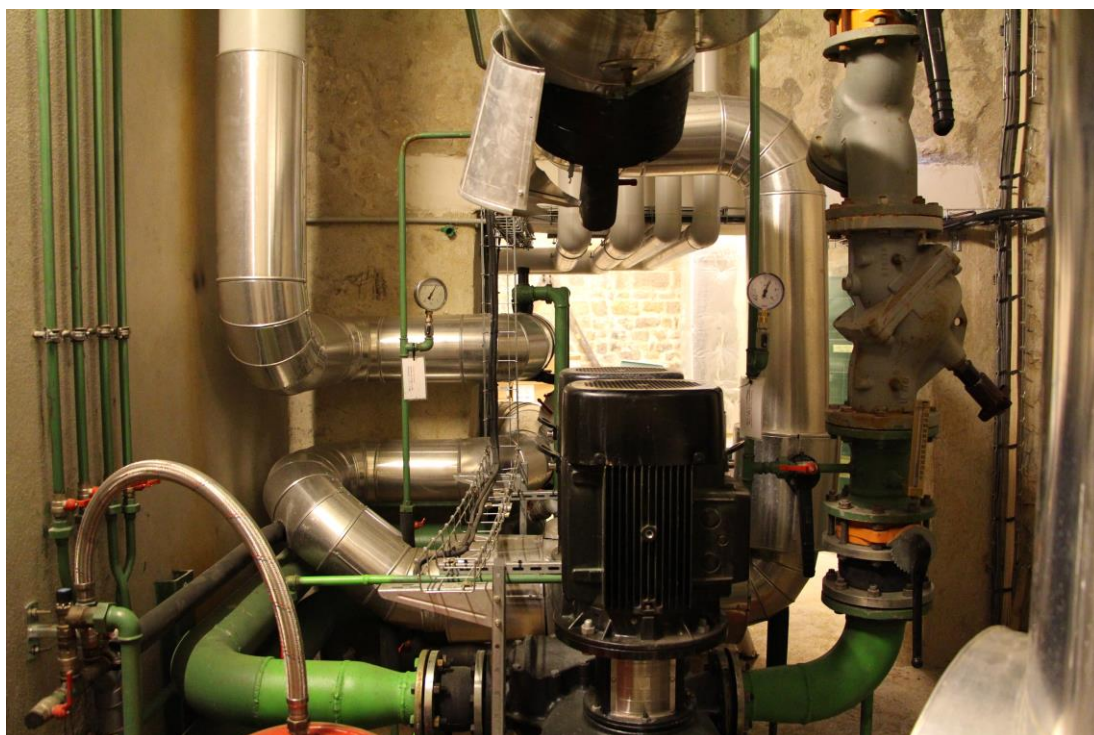
Local technique de climatisation
